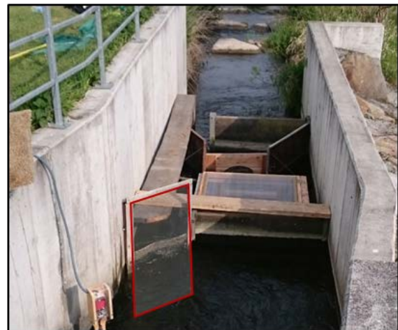
Abbildung 45: Monitoringdaten zur Untersuchung des Fischabstiegs an der FAH mittels Treibgutgitter (links) und Abbildung des Gitters in der FAH als Verkläusungsschutz der Reuse (rechts).
