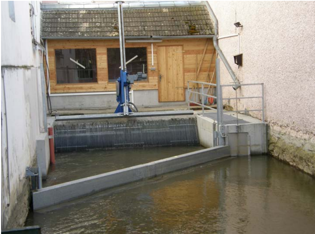
Abbildung 19: Krafthaus mit Tauchbalken (zur Abstiegsöffnung leitend) und Einstiegsbauwerk der FABH im Oberwasserkanal. Dahinter der Feinrechen und Rechenreinigungsanlage.
