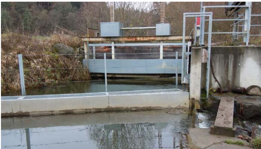
Abbildung 9: Tauchwand an der Wehranlage und daran anschließend der Dotationsschlitz für die Restwasserdotations. Dahinter: Dotationsbauwerk der FAH.
