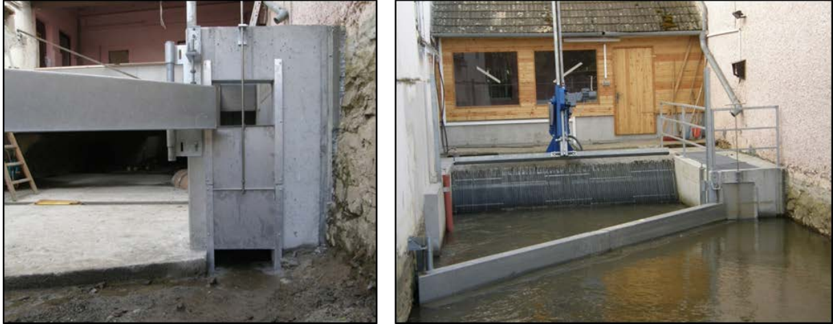
Abbildung 11: links: Leiteinrichtungen und Einstiegsöffnungen der Fischabstiegshilfe am Kraftwerk Riedmühle in trockenem Zustand. rechts: FAbH, Tauchwand und Feinrechen sowie Rechenreinigungsanlage im Regelbetrieb.
