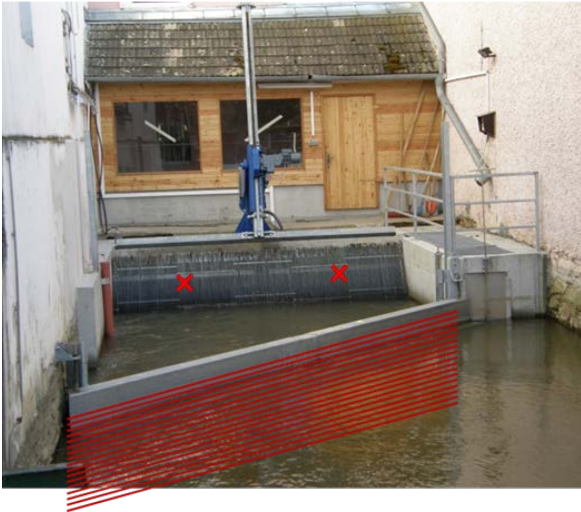
Abbildung 79: Variante zur Verlegung des Feinrechs (und eventuell horizontaler Anordnung der Stäbe) schräg in Richtung Abstiegsöffnung ausgerichtet.
