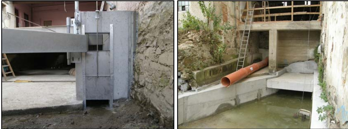
Abbildung 20: Einstieg der FAbH in trockenem Zustand mit den beiden Öffnungen und Leiteinrichtungen (links); Unterwasserseitiger Auslass der Bypassleitung – im Regelbetrieb fällt das Wasser aus der Bypassleitung aus einer Höhe von 30 cm in den Unterwasserkanal.
