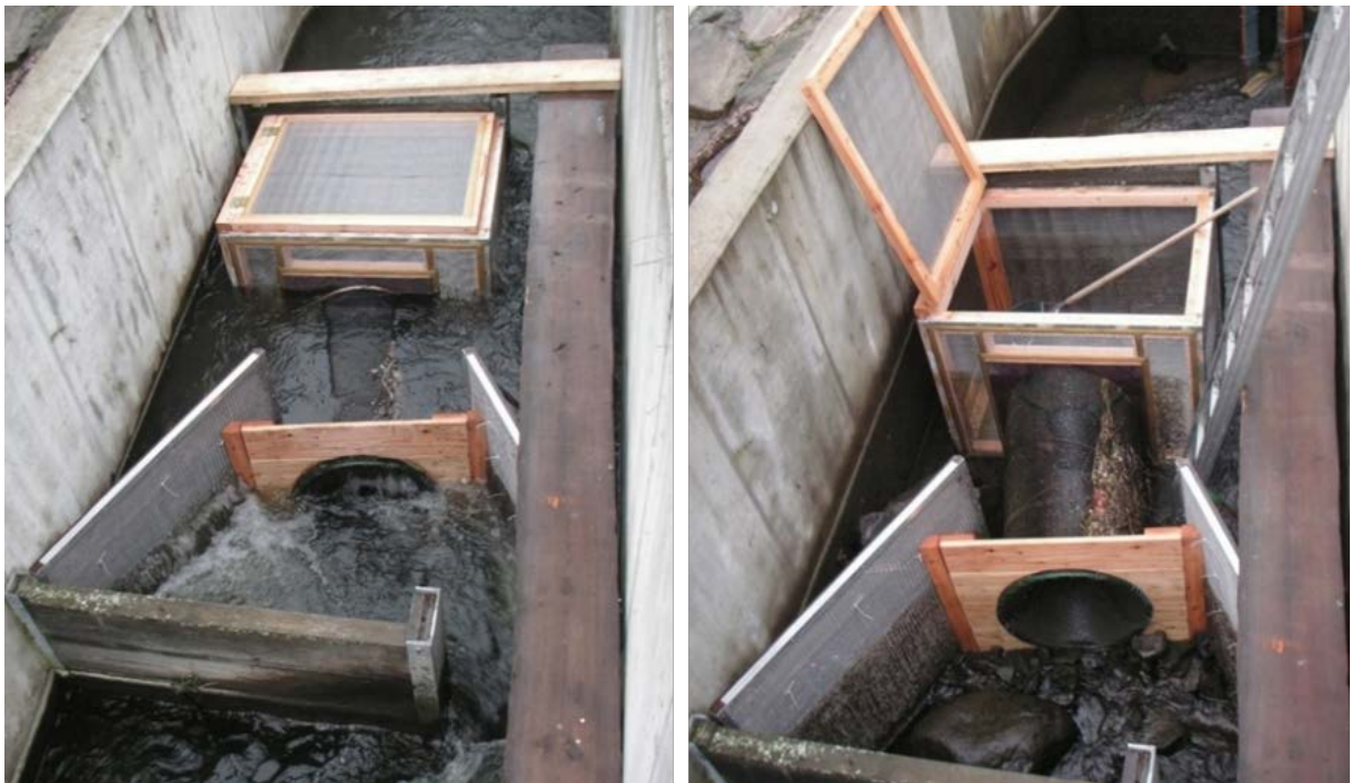
Abbildung 15: Installierter Reusenkasten an der FAH des KW Riedmühle bei dotierter und abgesenkter FAH.
